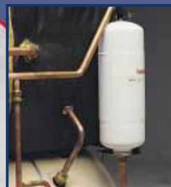
Vaso di espansione per circuito sanitario.
